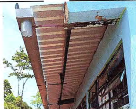
Foto 2: Canales y bajada de agua pluvial
